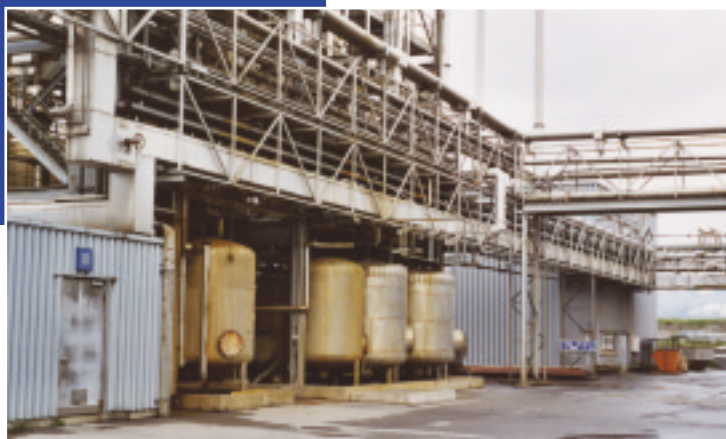
Opslag van vaste tanks
