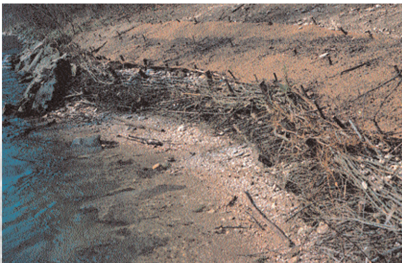
Ersatz der harten Uferverbauung durch ingenieurbiologischen Lebendverbau schafft Kies- und Beschattungsstrukturen an der Birs
