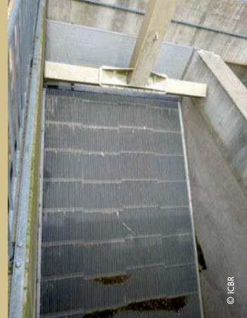
Roosters voorkomen dat vissen in de turbines van waterkrachtcentrales worden gezogen
